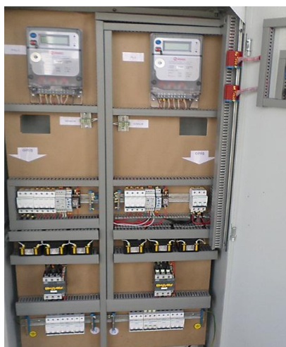
Щит автоматического управления освещением. ЩАУО
