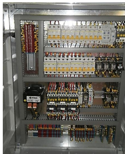
Щит автоматического управления опреснителя морской воды ЩАУ
