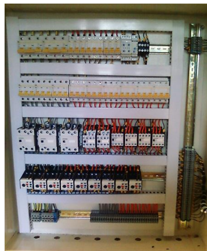
Щит управления насосами ЩУН
